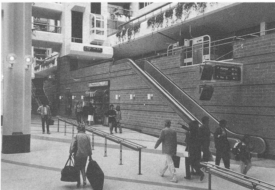
Rolltreppe Niveau 1/Niveau 2 im Busbahnhof
