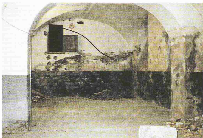
Bild 7. Mauerwerkschäden im Gewölberaum
