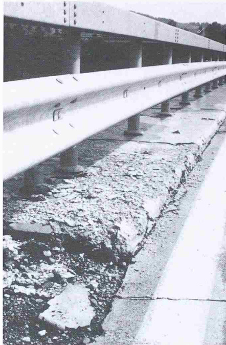
Bild 14. Zu dichter Schutzanstrich auf Betonkonsole. Kondensate darunter erhöhen Frostdruck, zusammen mit eingeschlossenen Chloriden sogar Frosttausalzbelastung. Der Beton wurde bei der Brücke dadurch überfordert
