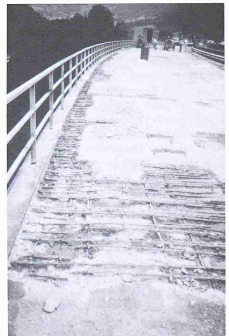
Bild 2. Verwitterungsschäden im Tiefbau
