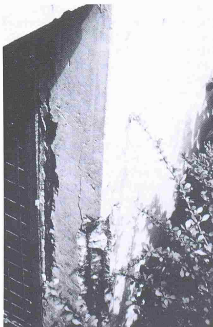
Bild 1. Verwitterungsschäden im Hochbau
