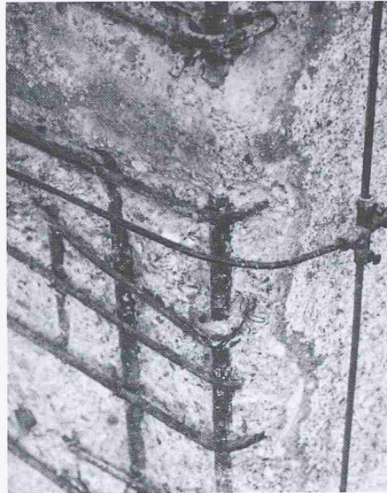
Bild 16. Der mineralische Putz verhin-derte über lange Zeit Karbonatisierung des Betons. Durch die Putzdichtigkeit entstand aber ungünstig hohe Betonfeuchtigkeit, was nach Betonkarbonatisierung zu totalen Korrosionssprengschäden führen musste. Detail Fassade Objekt Bild 17 1987 vor der Spritzbeton-Gesamterneuerung Armierungsüberdeckung.
