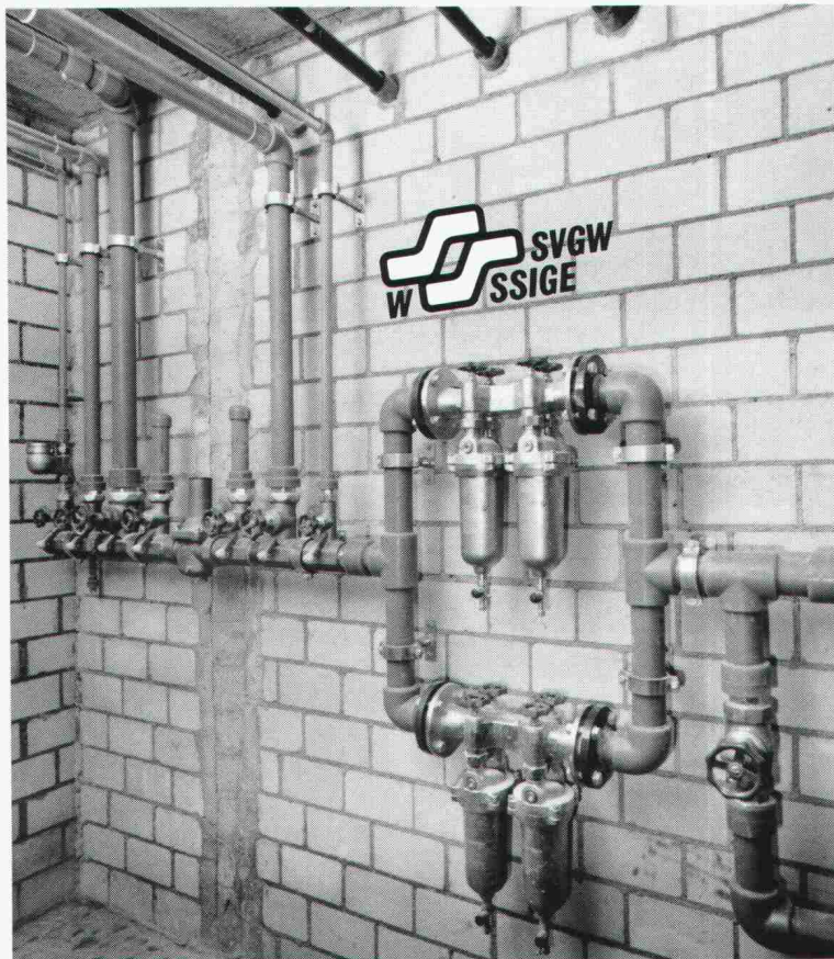
Verteilerbatterie in der Mövenpick-Raststätte «Heidiland» bei Sargans
