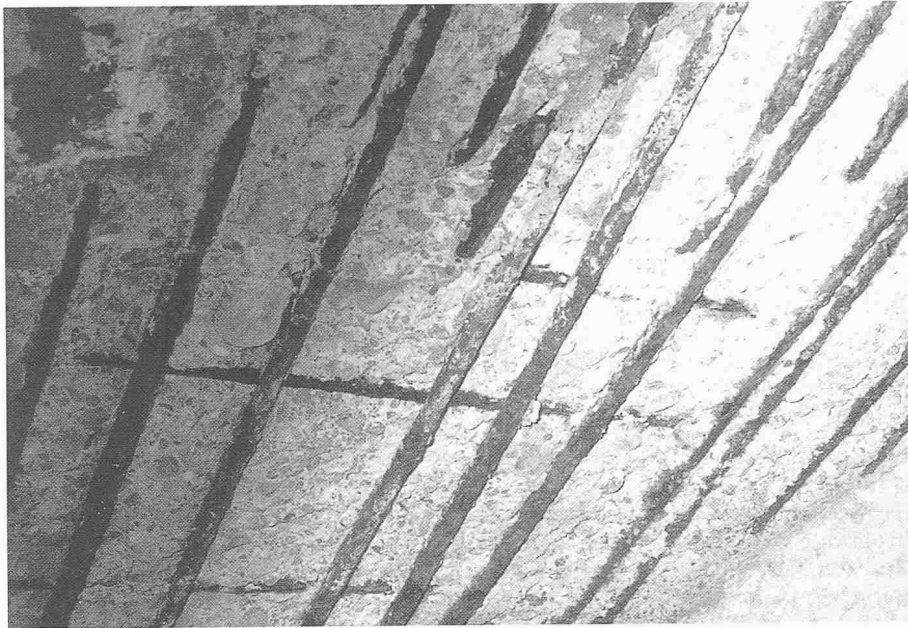
Bild 1. Korrodierte Bewehrungsstäbe haben die Betonüberdeckung abgesprengt
