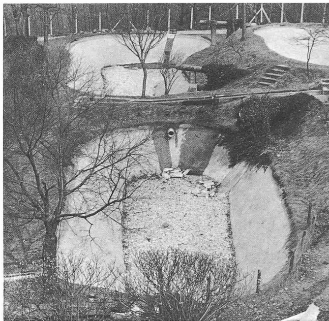
Bild 18. Mit Spritzbeton ausgekleidete Fischzuchtbecken. Abdichtung
