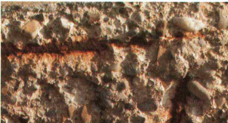
Betonabplatzungen infolge starker Armierungskorrosion.
