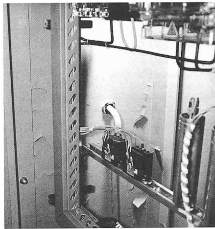
Bild 9. Rissbildung und teilweise Ablösung der Beschichtung
