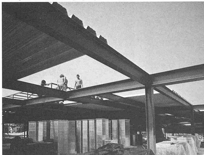
Bild 8. Im Baukastensystem verschraubte Dachträger eines Einkaufszentrums. Montage und Ausbau verlaufen fast parallel
