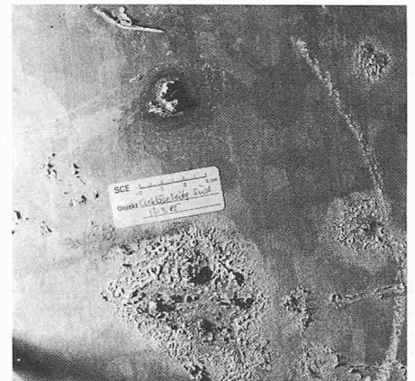
Bild 1. Verzinkungsfehler, die in der Verzinkerei nicht gesehen, von der Korrosionsschutzüberwachung auf der Baustelle jedoch entdeckt wurden
