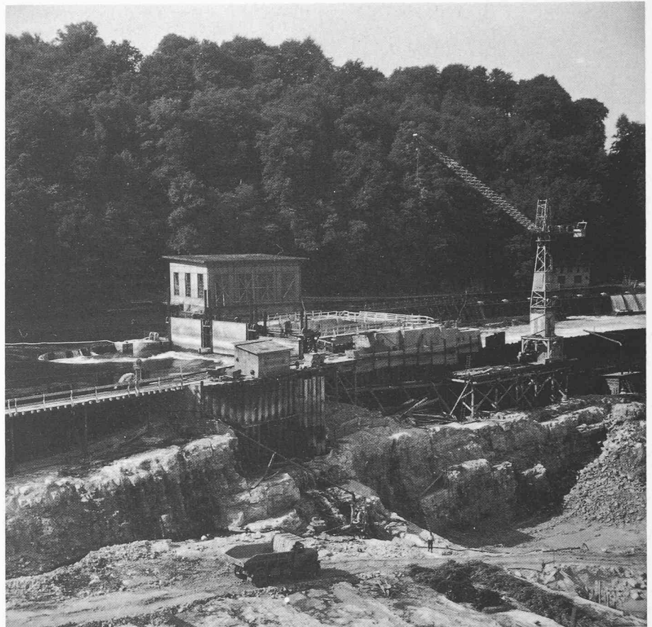
Bild 8. Aushub im Rheinbett für das Kraftwerk Schaffhausen, Blick nach Süden. Man beachte die Klüftung des Kalkfelsens und das Ausmass des Aushubs (Foto R. Fechtig 27.7.1961)
