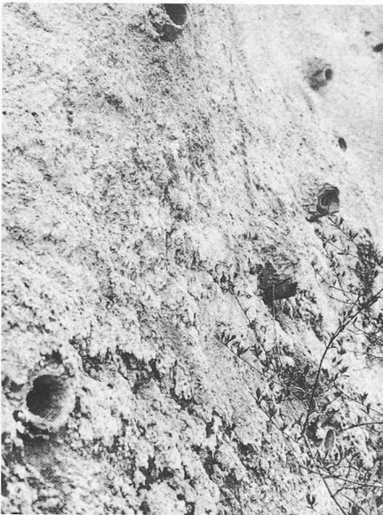
Bild 12. Unansehnliche Spritzbetonoberfläche («Überzähne»)
