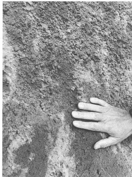
Bild 13. Unregelmässige Spritzbetonoberfläche (schwankende Rauheit)
