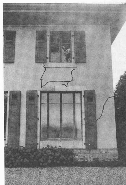
Fig. 3. Fissurations en façade du corps sud
