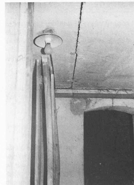
Fig. 4. Déformation des cloisons de séparation et fissuration au plafond d'une des caves
