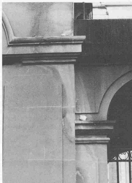
Bild 4. Pfeilerausschnitt mit beregneter und sickerwasserbenetzter Zone rechts (dunkel). Links angrenzend heller Saum mit vorwiegend Magnesiumformiat-Krusten und -Ausblühungen, an dessen linkem Rand der Sandstein durch Absanden stark beschädigt ist
