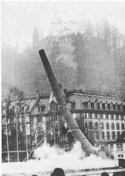
Bild 1. Beispiel für Knickstelle (Schlachthof Luzern)
