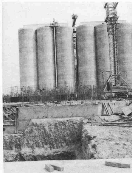
Bild 6. Mühle Quasseem, Saudi-Arabien. Getreidesilos der ersten Etappe und Maschinenhausbaugrube der zweiten Etappe (Photo Baustelle)
