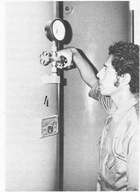
Bild 31. Gefährlich angeordneter Prüfmanometeranschluss
