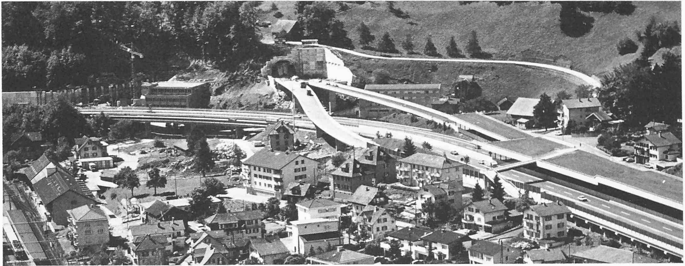
Bild 3. Anschluss N2/N8. Baulos 42. Brücken Ost und West. Nordportal des Loppertunnels (N8) mit Wendeplatz. Neues Unterwerk und Ankerwand (Baulos 52) im Bau
