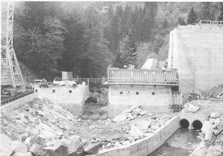
Bild 2. Das Sperrenbauwerk im Bau (12. Mai 1981). Blick aus dem Stauraum bachabwärts. Rechts im Vordergrund erkennt man die beiden Einläufe der Wasserumleitung während des ersten Teiles der Bauzeit (Doppelröhre unter dem rechten Sperrenflügel hindurch)
