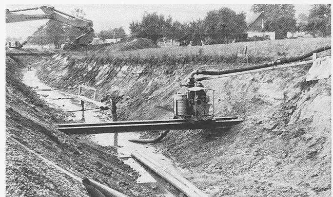
Bild 2. Mit dem Bagger wird eine rund 10 m lange Kunststoff-Dichtungsbahn abgesenkt und in der Kanalachse verlegt. Die beiden Enden der Bahn liegen nach dem Absenken auf vorher bereitgelegten Brettern, wodurch das nachfolgende Zusammenschweissen zweier Bahnen erleichtert wird
