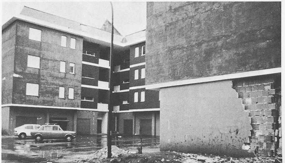
Bild 15. Schäden an einem U-förmigen Gebäude in Avellino bei einer Intensität VII. Die Schäden wurden wegen der aus Asymmetrie resultierenden Torsion verstärkt. Die Wände sind zweischalig ausgeführt, die Backsteine liegend versetzt
