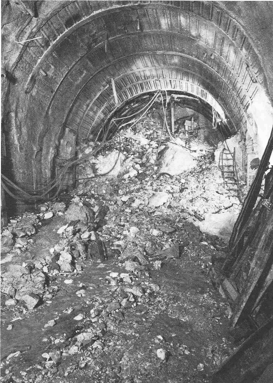
TM 3380: Einbruch von Wasser, Schlamm und Gestein im Bereich des Rotondogranits (29. Juni 1977). Die Vortriebsarbeiten wurden um sechs Monate verzögert
