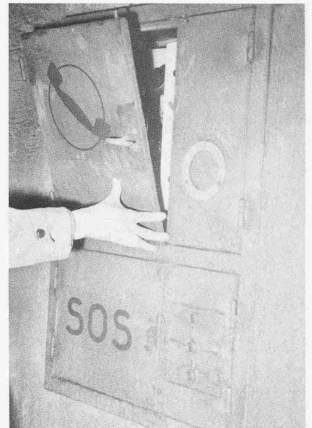
Bild 1. Stark korrodierter SOS-Kasten in einem Nationalstrassentunnel
