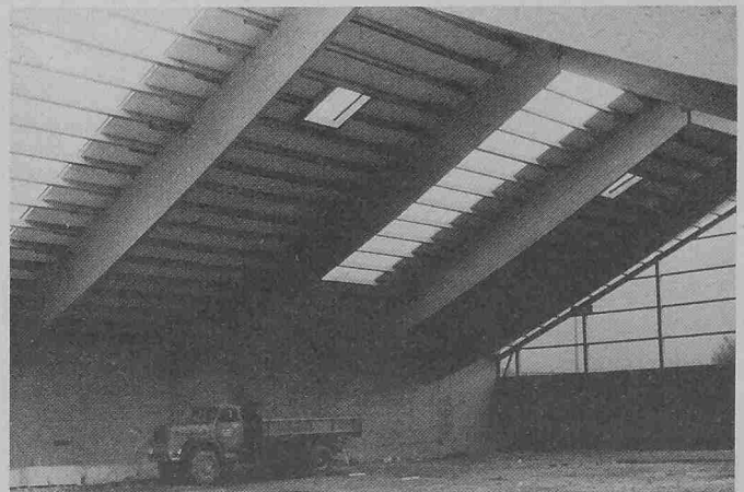
Tennishalle Bad Ragaz mit Gantner Isolier-Unterdach
