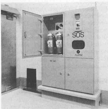
Bild 24. Alarmkasten in Schutzraum Figura 24 Armadio d'allarme in un rifugio
