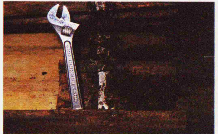
Bild 12. Geöffnete Überlappung mit Überresten eines Dichtungsbandes. Sehr starke Korrosion bis zur Perforation im Bereich der Überlappung
