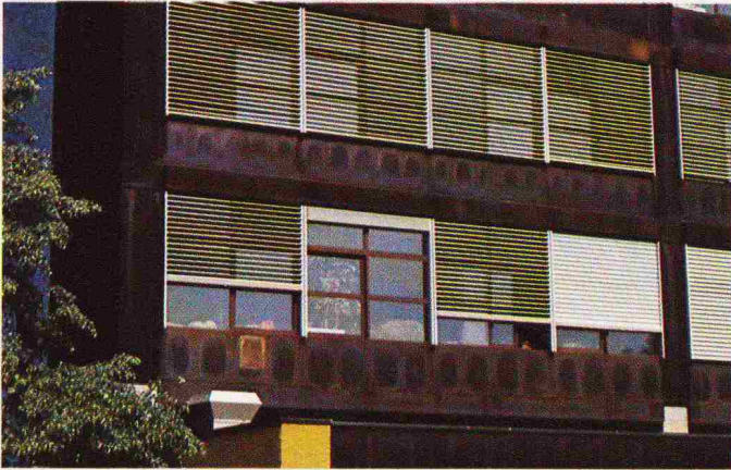
Bild 8. Unregelmässige Färbung von Fassadenelementen, verursacht durch unterschiedliche Wärmeableitung (und damit unterschiedlich lange Feuchtperioden) an Stellen, wo im Elementinnern Stege als Abstandhalter angeheftet waren
