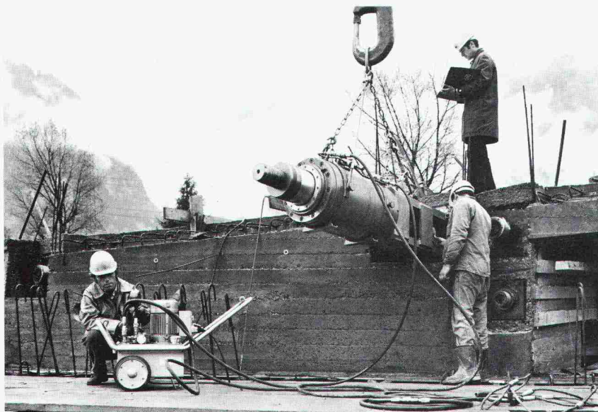
Spann- und Injektionsarbeiten werden durch Bauführer der STAHLTON AG überwacht, kontrolliert und protokolliert.
