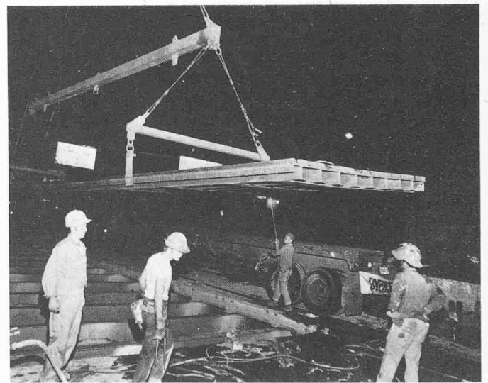
Der Einbau der verstärkten Stahlplatten mit dem Fahrbahnbelag erfolgt in Einheiten von ca. 3×18 m
