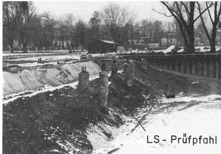
Bild 8. Im Zuge des Aushubs ausgegrabene Zeissl- und LS-Pfähle der Probelastungsversuche. Links im Bild die mit Plastik abgedeckte Böschung des Voraushubs, welcher in der ersten Bauphase zur Ableitung des Schmutzwassers aus der Auffüllschicht diente (s. auch Bild 10)
