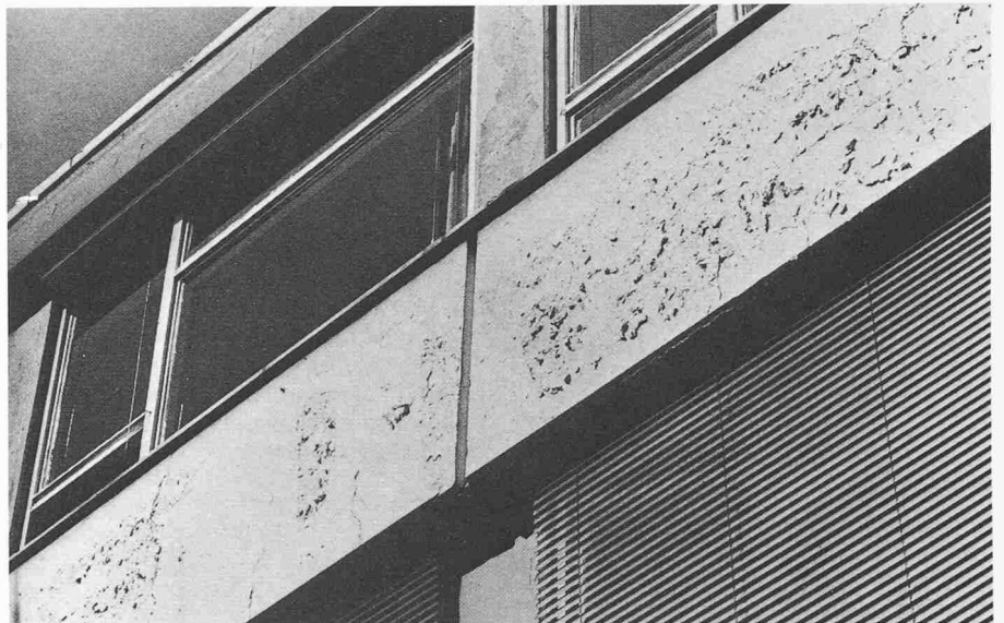
Bei ungenügend abgedeckter Bewehrung entstehen durch thermische Belastungen Volumenveränderungen, die zur Rissbildung führen
