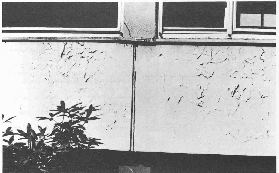
Durch Bindemittelanreicherung in der Oberfläche und unterschiedliche Ausdehnungskoeffizienten von Beton und Oberfläche (Sinterhaut) entstehen Risse, die durch einen normalen Anstrich durchgehen und zu Ablösungen führen
