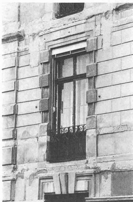
Schäden auf der Südwestseite
