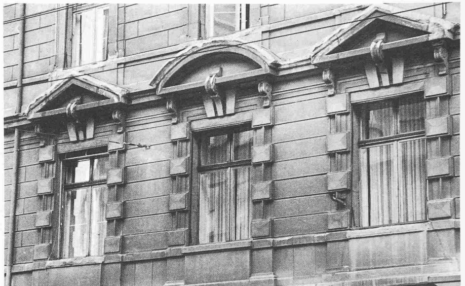
Verwitterungsschäden an den Dreieck- und Segmentgiebeln der Hauptfassade
