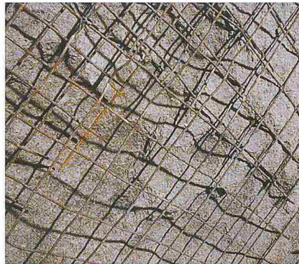
1 Zerstörter Beton und freigelegte Armierung nach Brandbelastung
