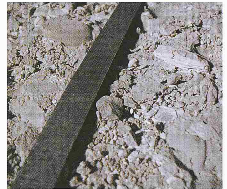
2 Zerstörte Betonstruktur und Zuschlagstoffkomponenten
