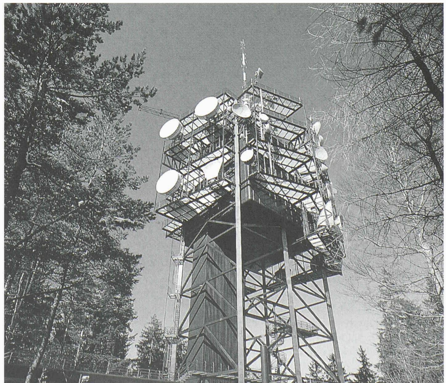
Gesamtansicht der Mehrzweckanlage Ulmizberg
