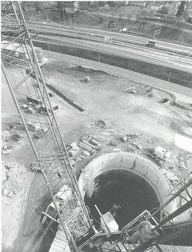
Angriffsschacht für den unterirdischen Teil der zweiten Doppelspur Zürich HB–Thalwil auf der Allmend Brunau (Bild: Comet)
