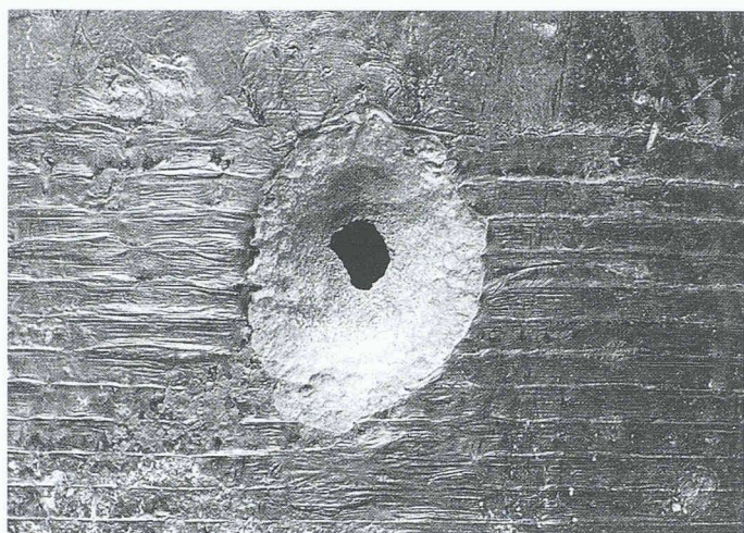
4 Durch einen Gleichstrom verursachter Korrosionsangriff auf eine Rohrleitung
