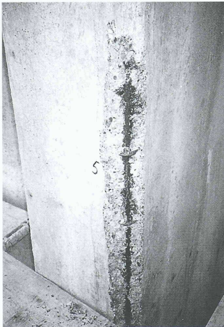
6 Betonabplatzung und rostige Bewehrung (Längsseisen und Bügel: Querschnittsverminderung rund 10% infolge chloridinduzierter Korrosion)
