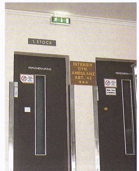
Kürzlich neu an der Decke eines Spitals montierte Fluchtwegzeichen, die zuerst vom Rauch verdeckt werden und zudem ausgerechnet über dem nicht zu benützenden Lift stehen (Bild: B. Hersche)
