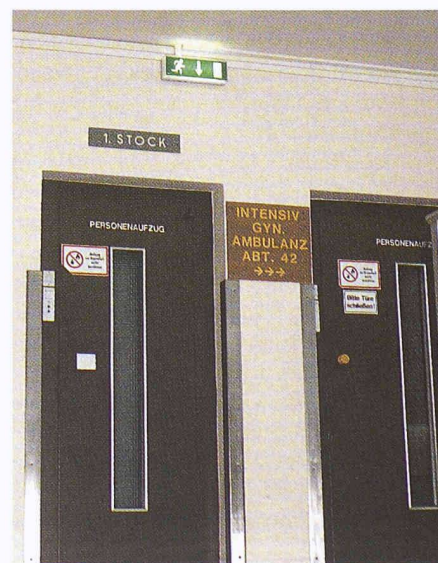
Kürzlich neu an der Decke eines Spitals montierte Fluchtwegzeichen, die zuerst vom Rauch verdeckt werden und zudem ausgerechnet über dem nicht zu benützenden Lift stehen (Bild: B. Hersche)
