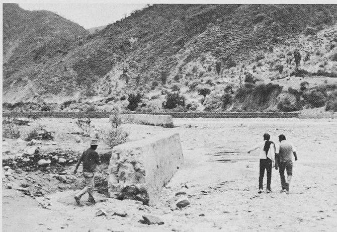
Bild 1. Uferschutzmauer. Das raschere Wegfliessen in der Nähe der Mauer führt zu einem seitwärts gerichteten Zufluss aus der Mitte des Flussbettes (Bild: E. Decormis, Sucre)
