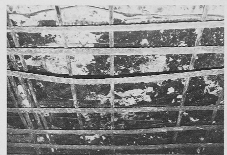
Bild 8. Unterseite Fahrbahnplatte Brandbereich
