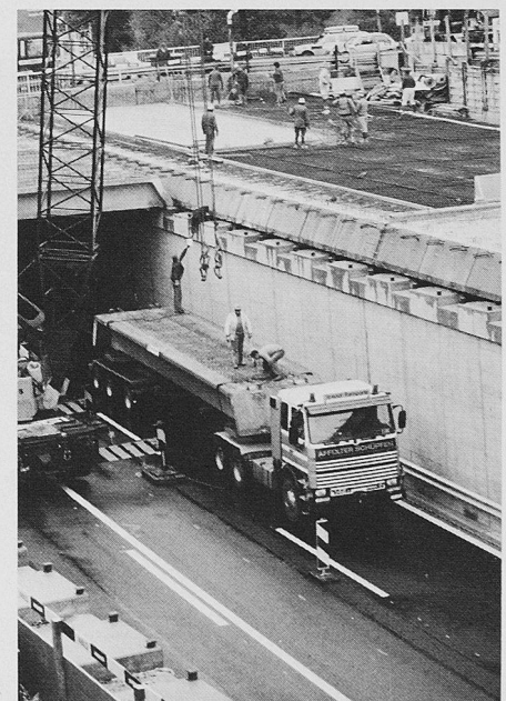
Bild 3. Vorfabrizierte Betonelemente werden montiert und mit dem Überbeton untereinander verbunden (November 1991, Foto H. Müller)
