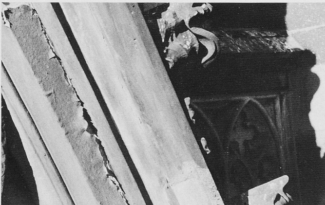
Schalenbildung beim Gewände des Hauptportales. Ursache: Zum Schutz vor dem Absanden wurden früher organische Polymere aufgetragen, dadurch Verfärbung und Schalenbildung
