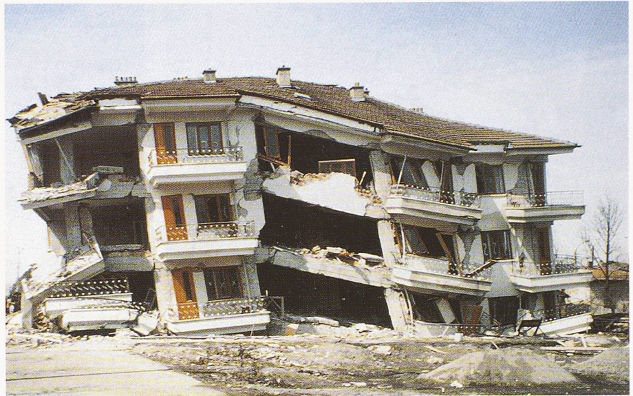
Bild 11. Stahlbetonskelettbau mit Backsteinaufmachungen. Auffällig sind die Trennrisse und Betonzerstörungen in den Gelenkbereichen
