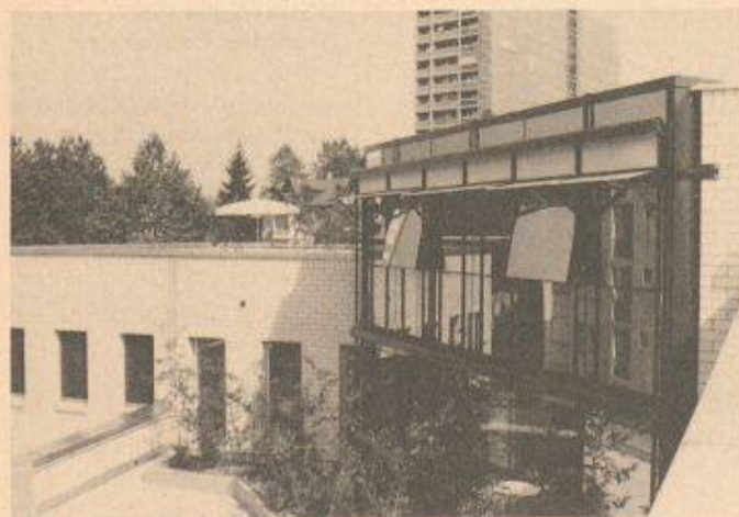
Die nachträglich angebrachte Tragkonstruktion für die Sonnenstoren beim SVB-Verwaltungsgebäude in Worblaufen BE
