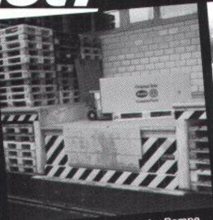
z.B. Scherenhebebühne in der Rampe eingebaut, mit eingehängtem Überfahrblech und Spezial-Sicherheitsblechschürze.
