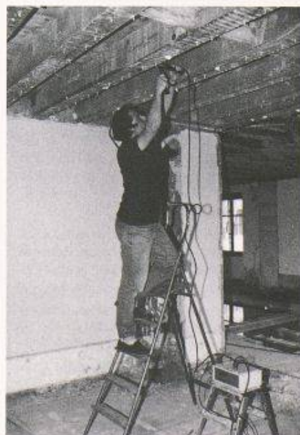
Bild 1. Mit der Ultraschall-Messung kann mit Sicherheit gesagt werden, welches Gewicht die Balkenlage aushalten kann
