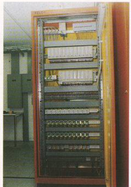
Bild 4. Unterverteilung mit Simatic ET 100
