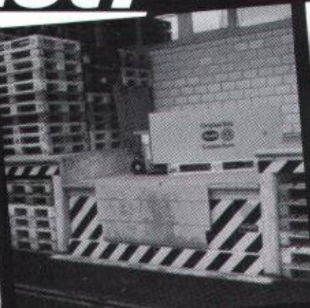
z. B. Scherenhebebühne in der Rampe eingebaut, mit eingehängtem Überfahrblech und Spezial-Sicherheitsblechschürze.
