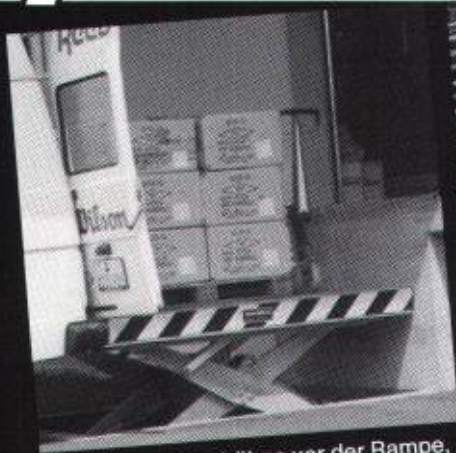
z. B. Scherenhebebühne vor der Rampe, abgesenkt mit Lastwagen überfahrbar.
