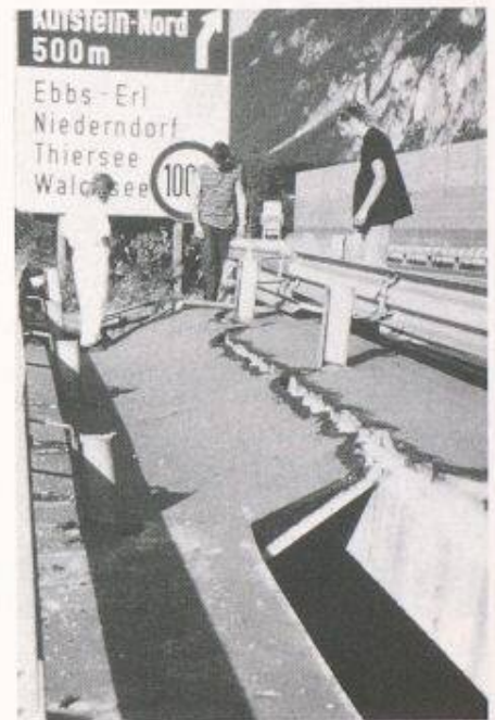
Bild 1. Inntalbrücke bei Kufstein nach dem Schadensfall
