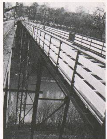
Der Fussgängersteg mit 180 m Länge läuft dicht neben der Lorrainebrücke (Bild: Senn AG)
