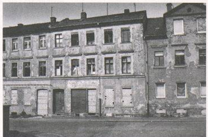
Bild 2. Mangel an Unterhalt infolge unrealistisch tiefer Mietzinsse hat einen beispiellosen Zerfall der Bausubstanz bewirkt. Undichte Dächer lassen zunächst die oberen Geschosse unbewohnbar werden; mit der Zeit schreitet die Aushöhlung weiter nach unten fort, bis schliesslich der ganze Bau aufgegeben werden muss
